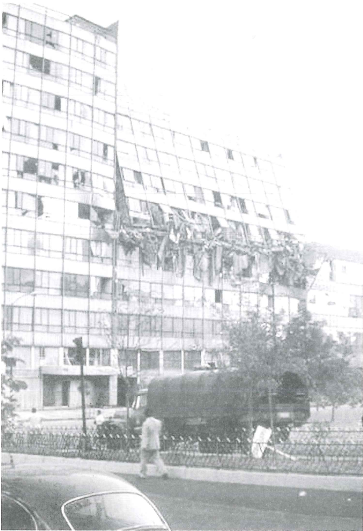
Parte de este edificio ha roto, separado de su parte lateral por una junta de dilatación. Como no ha colapsado, pueden haberse salvado muchas vidas, incluso en la parte volcada. Obsérvese, como, curiosamente, muchos vidrios del edificio permanecen intactos.
