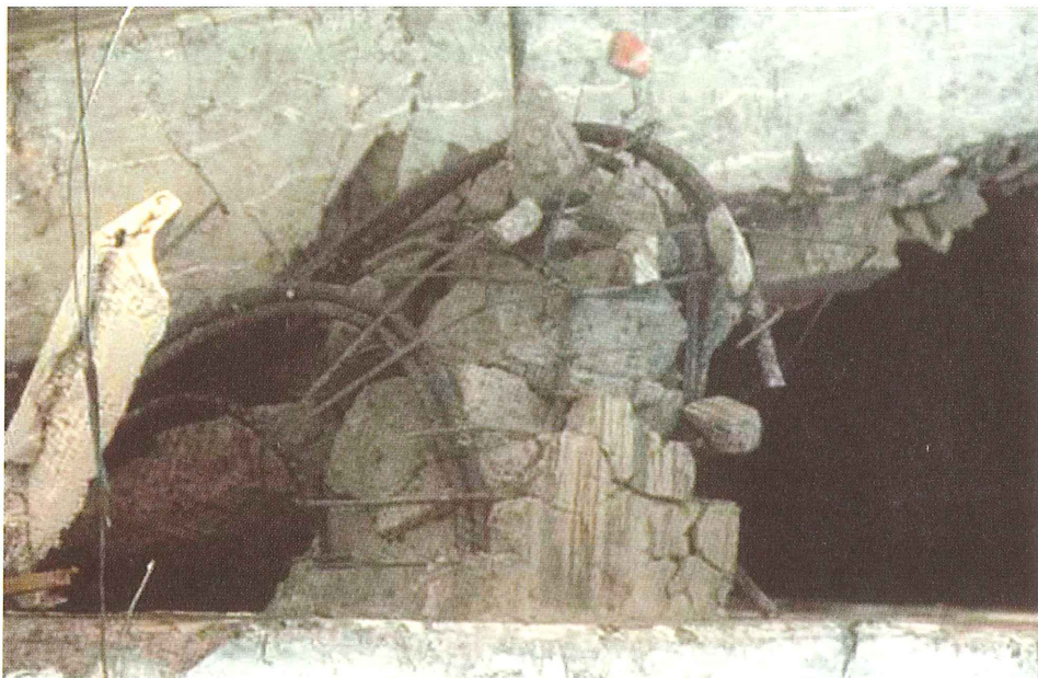
Detalle de un pilar que no ha resistido.
